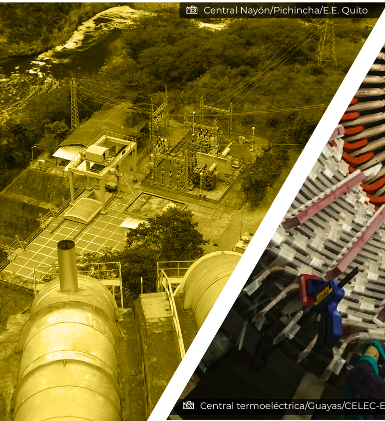
Subestación/El Oro/CNEL-El Oro
